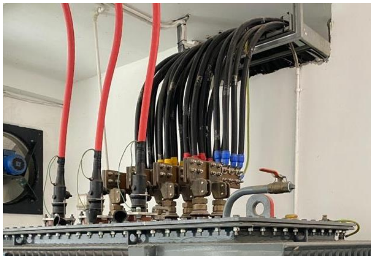
GAMBAR 2. Kabel tegangan menengah dan tegangan rendah pada transformator trafindo.
